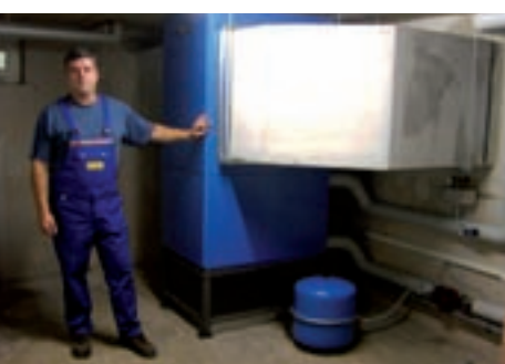
Neue Wärmepumpe in der August-Rudloff-Straße
